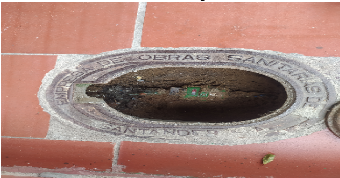
Contador de Agua
