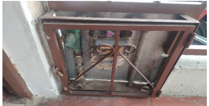
Contador de Gas
