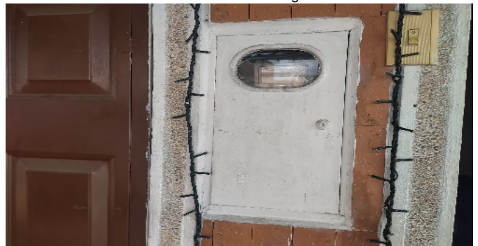
Contador de Energia
