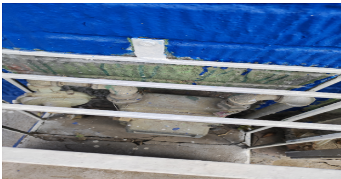
Contador de Gas
