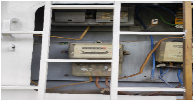
Contador de Energia
