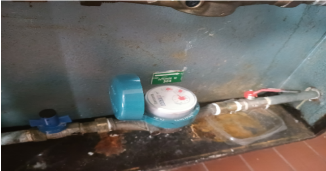
Contador de Agua
