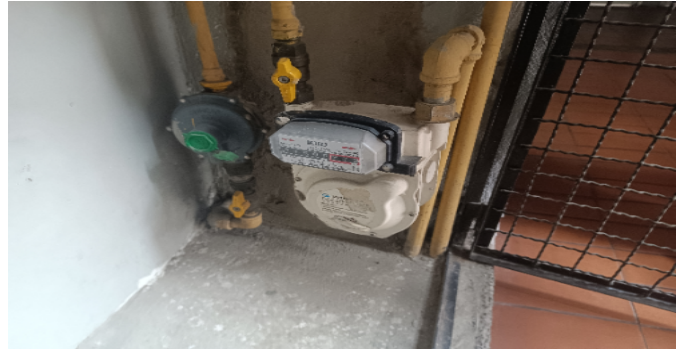
Contador de Gas
