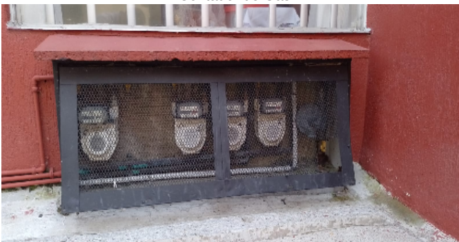
Contador de Gas
