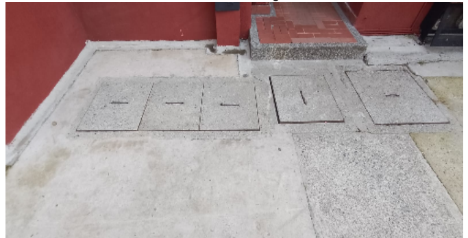
Contador de Agua
