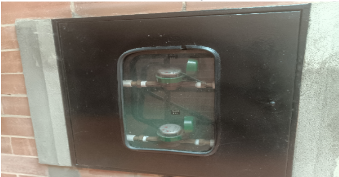
Contador de Agua
