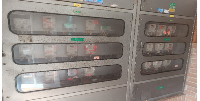
Contador de Energia
