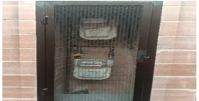
Contador de Gas
