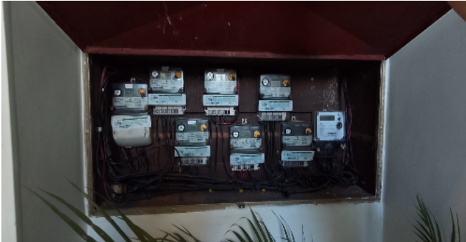
Contador de Energia
