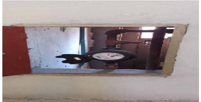
Contador de Agua
