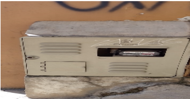
Contador de Gas
