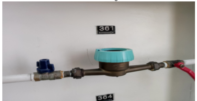
Contador de Agua
