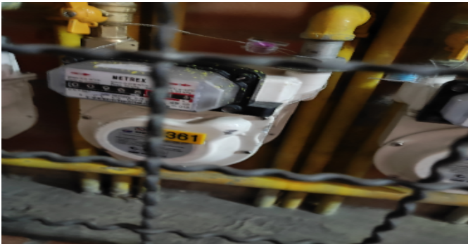
Contador de Gas
