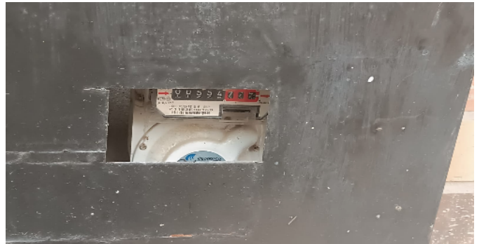
Contador de Gas
