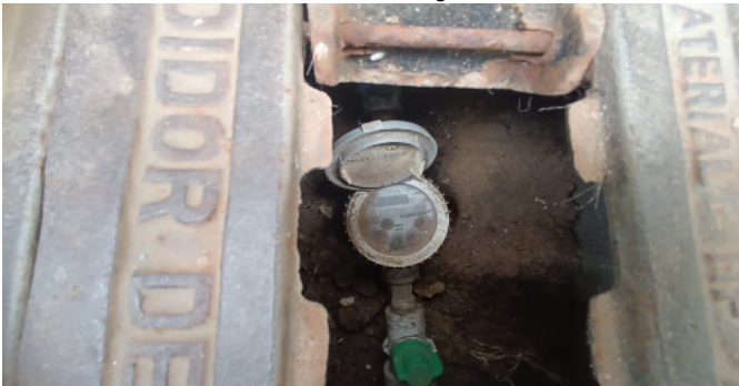
Contador de Agua
