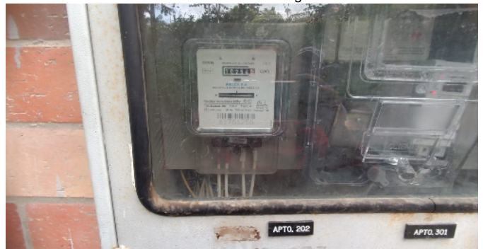
Contador de Energia
