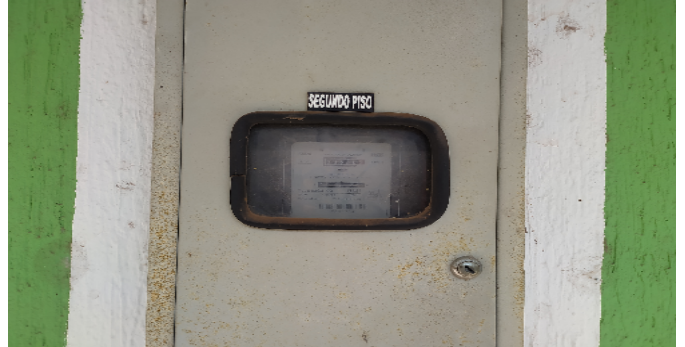
Contador de Energia
