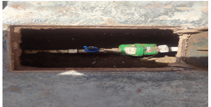
Contador de Agua
