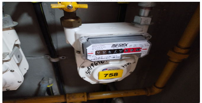
Contador de Gas
