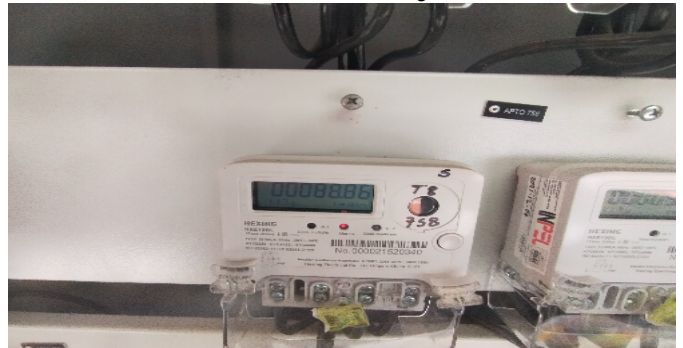
Contador de Energia
