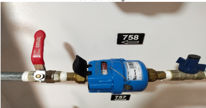
Contador de Agua
