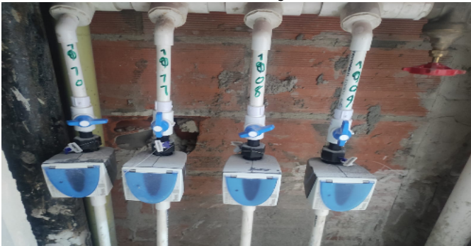
Contador de Agua
