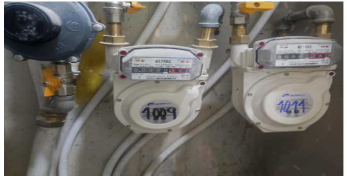
Contador de Gas
