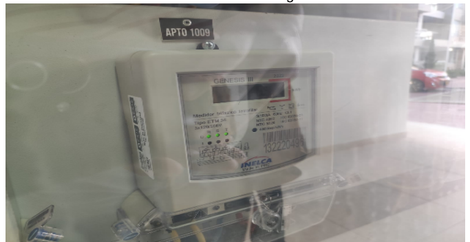
Contador de Energia
