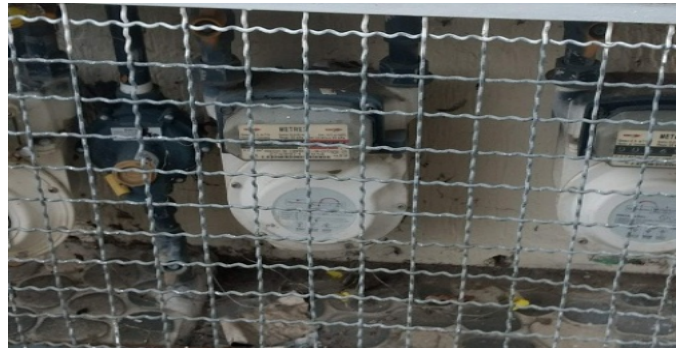
Contador de Gas
