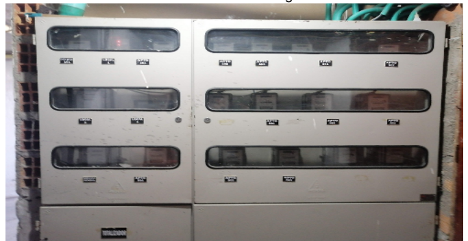
Contador de Energia
