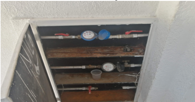
Contador de Agua
