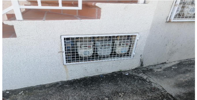
Contador de Gas
