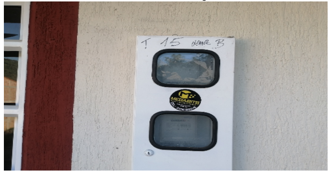
Contador de Energia
