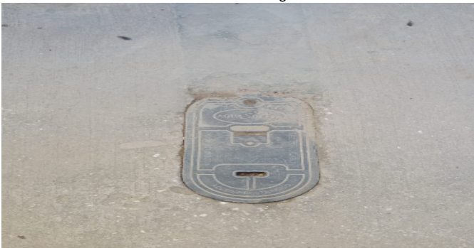
Contador de Agua
