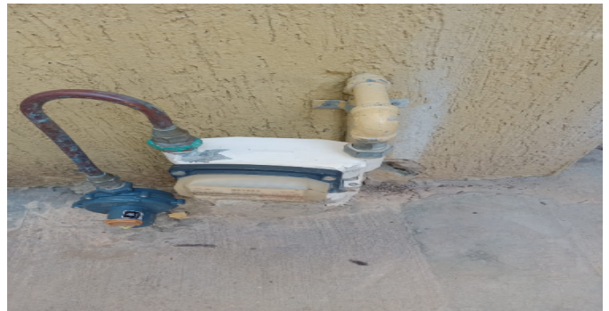
Contador de Gas
