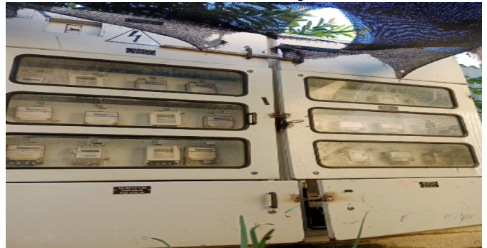
Contador de Energia
