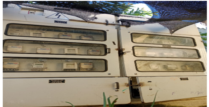
Contador de Energia
