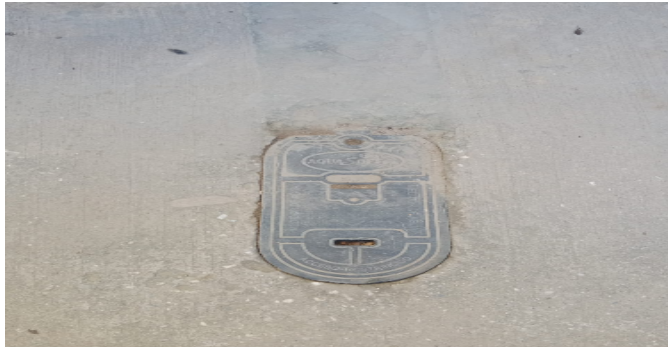
Contador de Agua
