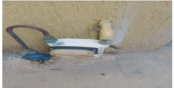
Contador de Gas
