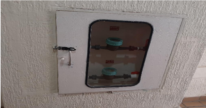
Contador de Agua
