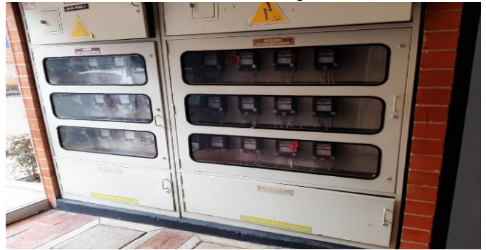
Contador de Energia
