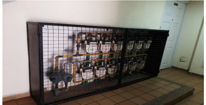
Contador de Gas
