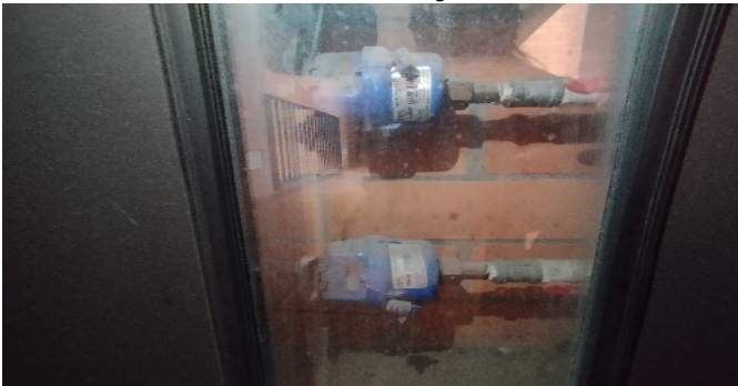
Contador de Agua
