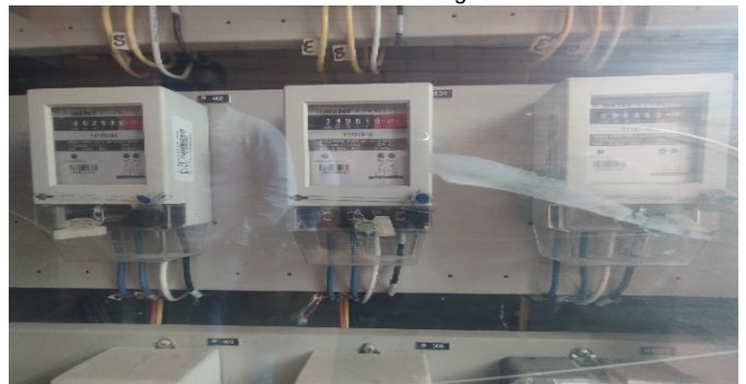
Contador de Energia
