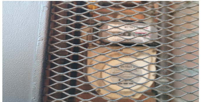
Contador de Gas
