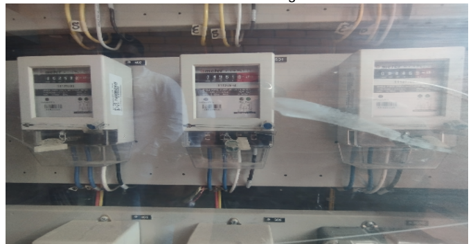
Contador de Energia
