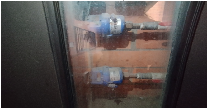
Contador de Agua
