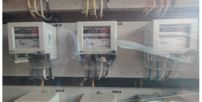
Contador de Energia
