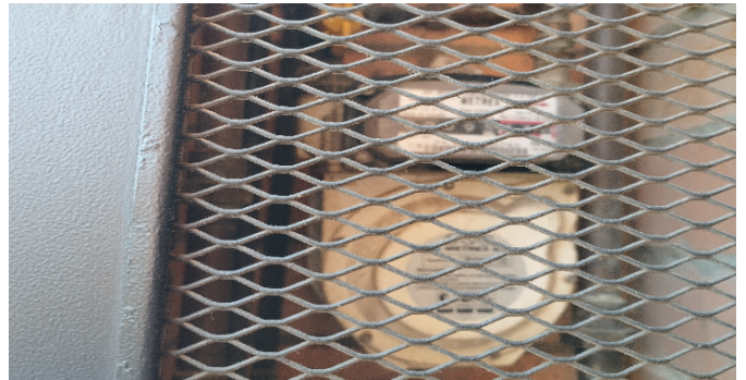
Contador de Gas
