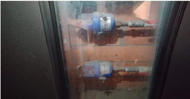
Contador de Agua
