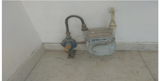
Contador de Gas
