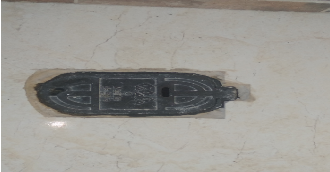
Contador de Agua
