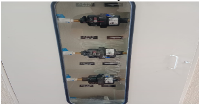
Contador de Agua
