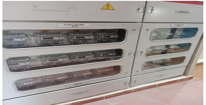
Contador de Energia
