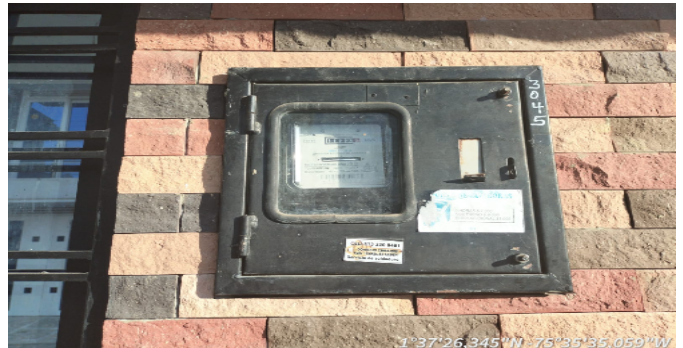
Contador de Gas
