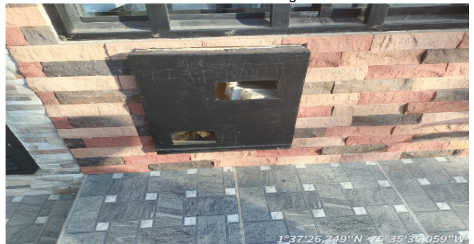
Contador de Energia
