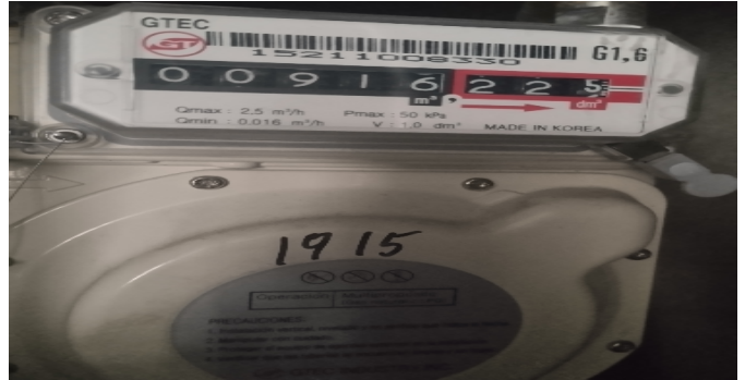
Contador de Gas
