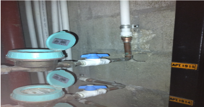
Contador de Agua
