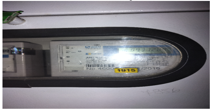
Contador de Energia
