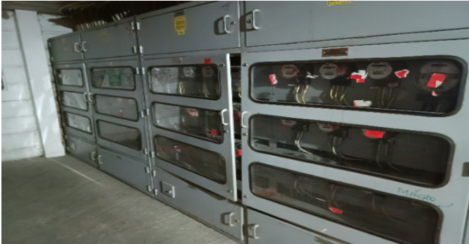
Contador de Energia
