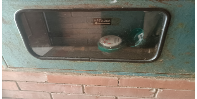
Contador de Agua
