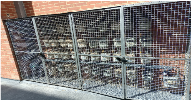
Contador de Gas
