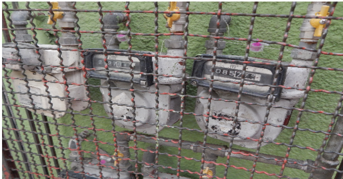
Contador de Gas
