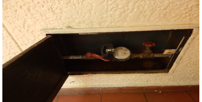
Contador de Agua
