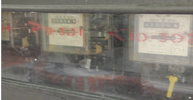
Contador de Energia
