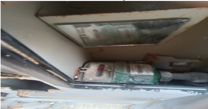
Contador de Agua
