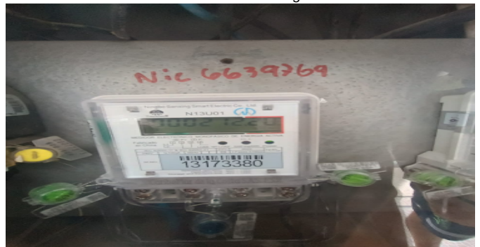
Contador de Energia
