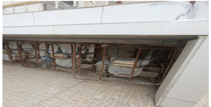
Contador de Gas
