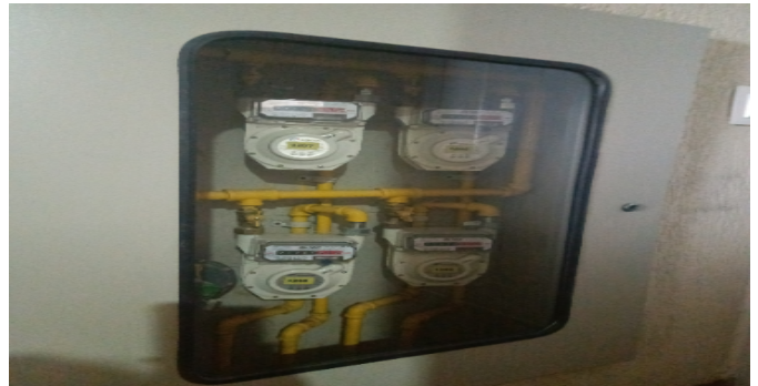
Contador de Gas
