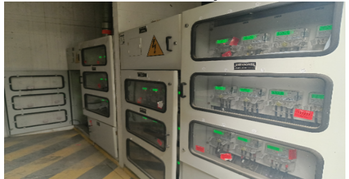
Contador de Energia
