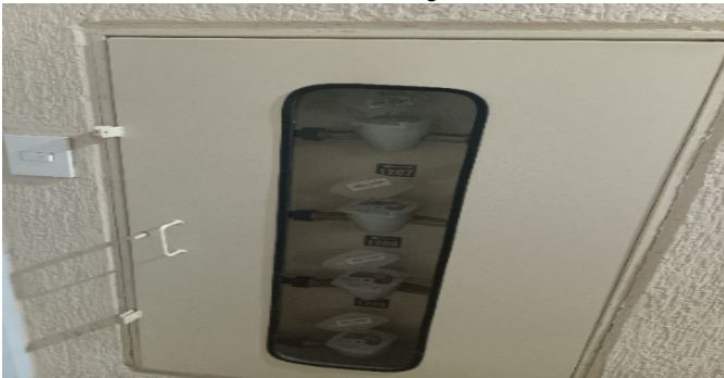
Contador de Agua
