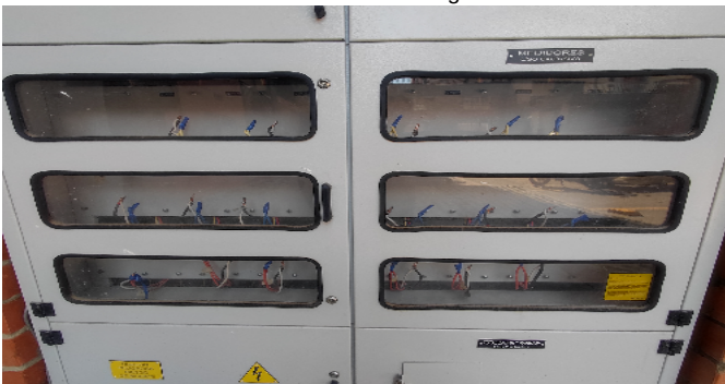
Contador de Energia
