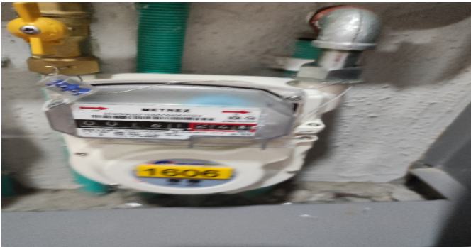
Contador de Gas
