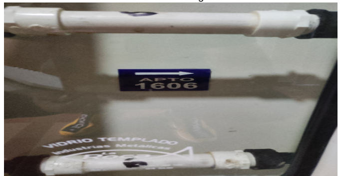
Contador de Agua
