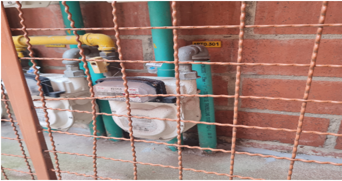
Contador de Gas
