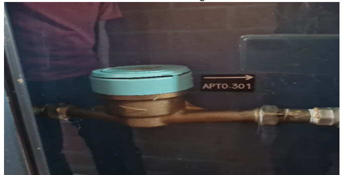
Contador de Agua
