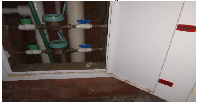
Contador de Agua
