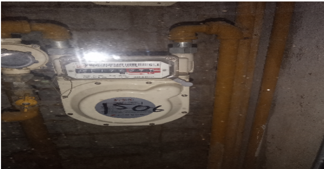
Contador de Gas
