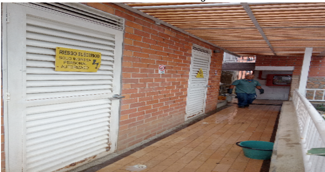
Contador de Energia
