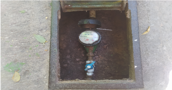
Contador de Agua
