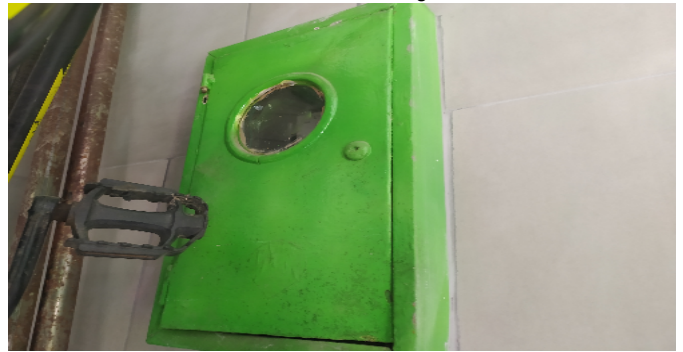
Contador de Energia
