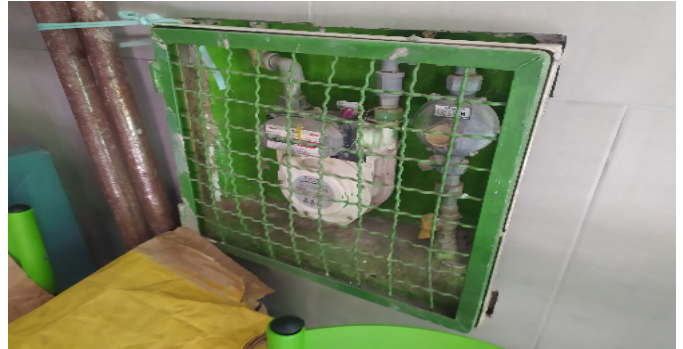
Contador de Gas
