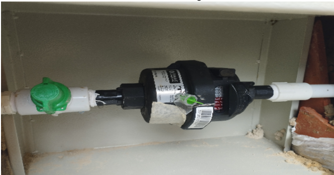
Contador de Agua
