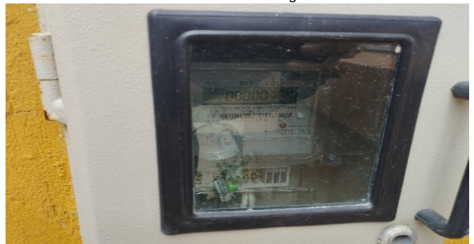
Contador de Energia
