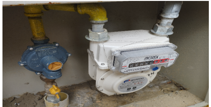
Contador de Gas
