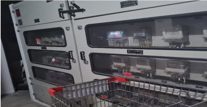
Contador de Energia
