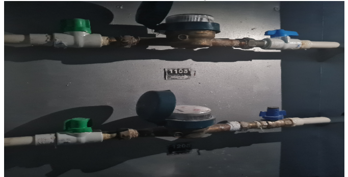
Contador de Agua
