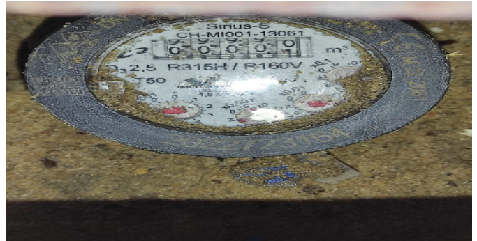
Contador de Agua
