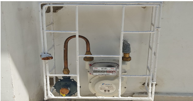
Contador de Gas
