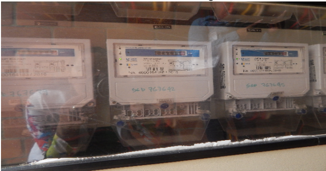
Contador de Energia
