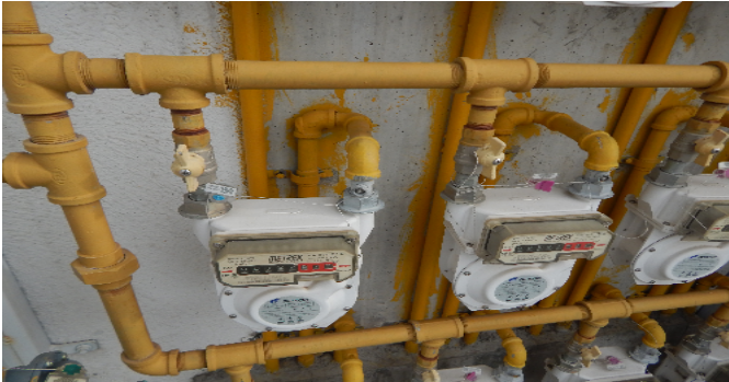
Contador de Gas
