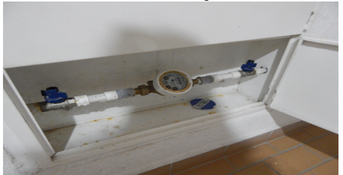
Contador de Agua
