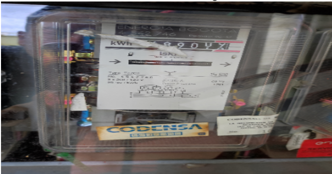
Contador de Energia
