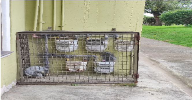
Contador de Gas
