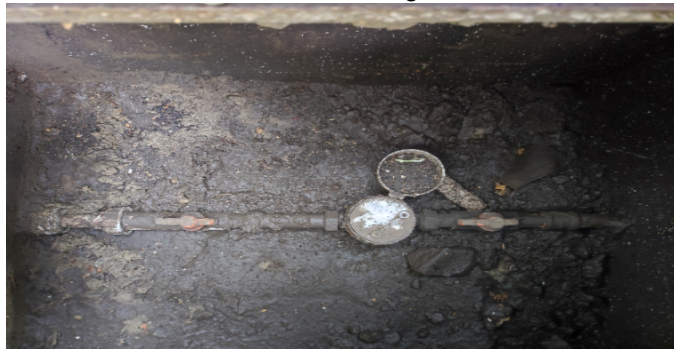
Contador de Agua
