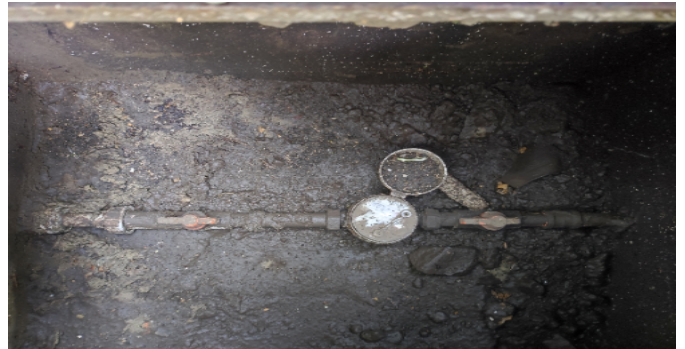
Contador de Agua
