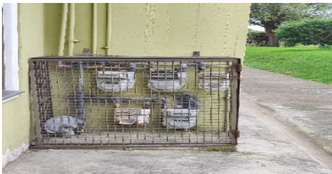
Contador de Gas
