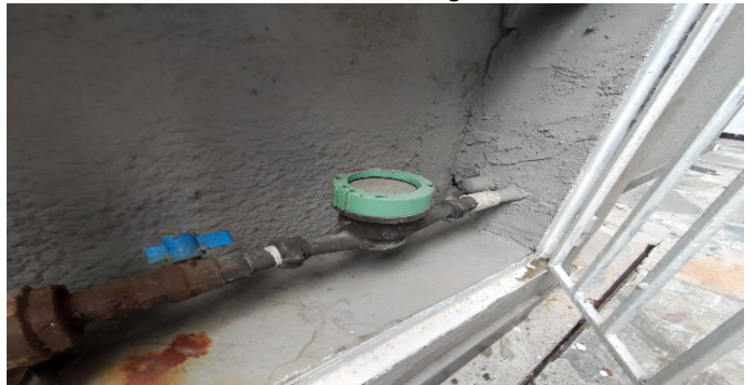
Contador de Agua
