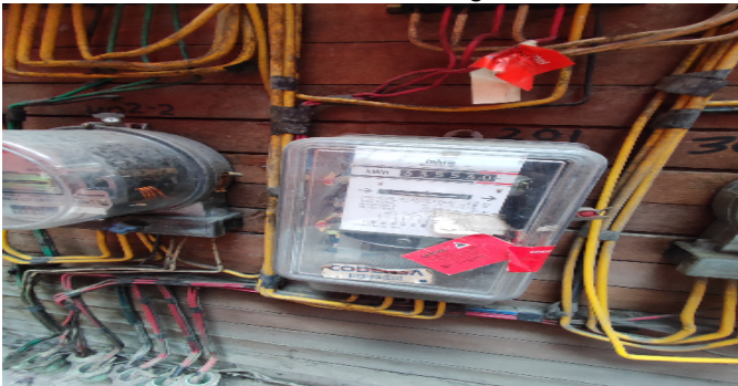
Contador de Energia
