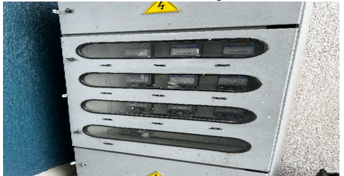
Contador de Energia
