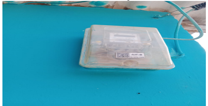
Contador de Energia
