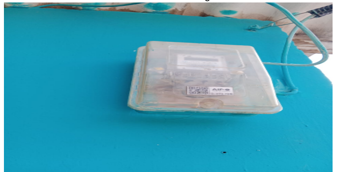
Contador de Energía
