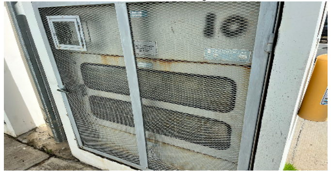
Contador de Energia
