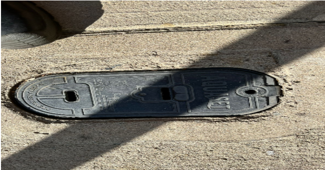
Contador de Agua
