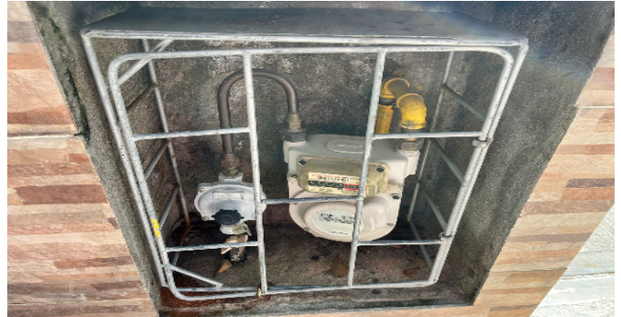
Contador de Gas
