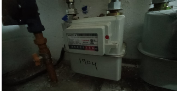
Contador de Gas
