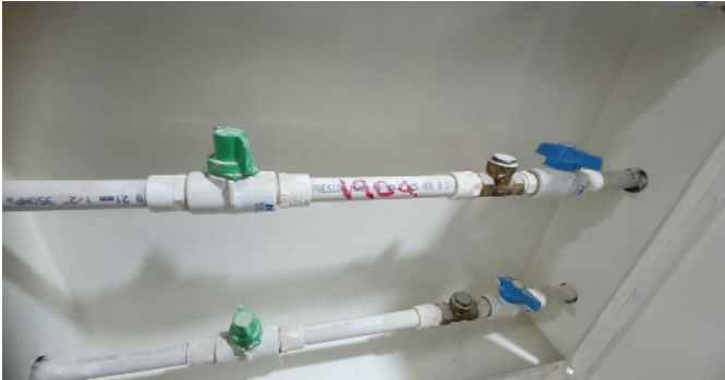
Contador de Agua
