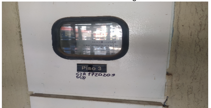
Contador de Energia
