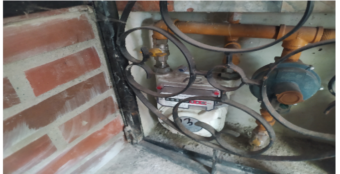
Contador de Gas
