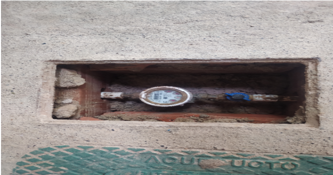
Contador de Agua
