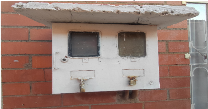
Contador de Energia
