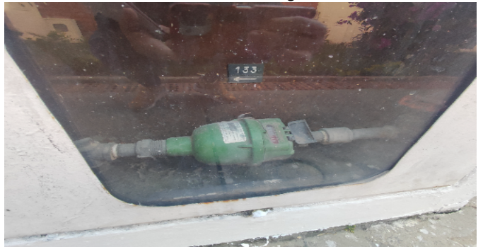
Contador de Agua
