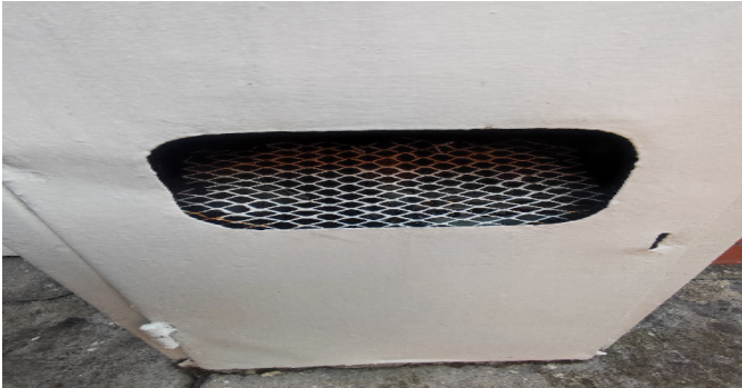
Contador de Gas
