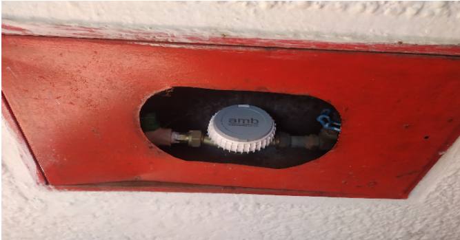
Contador de Agua
