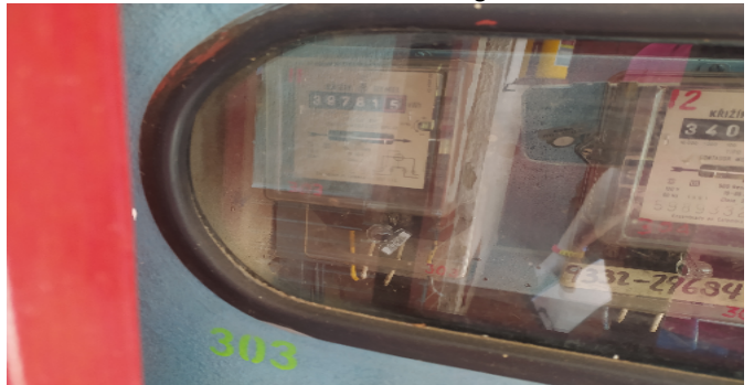
Contador de Energia
