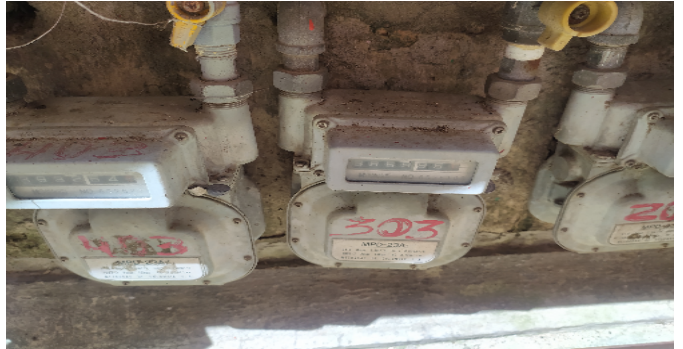
Contador de Gas
