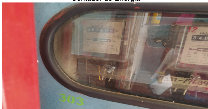
Contador de Energia
