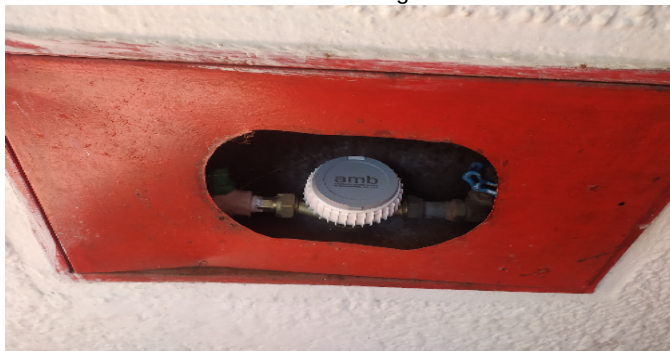
Contador de Agua
