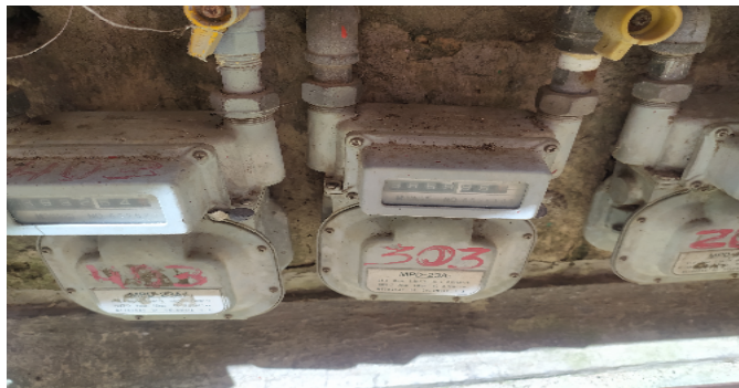
Contador de Gas
